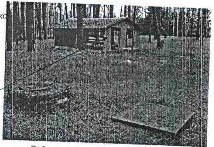
Водопроводные колодцы ВК3, ВК4
