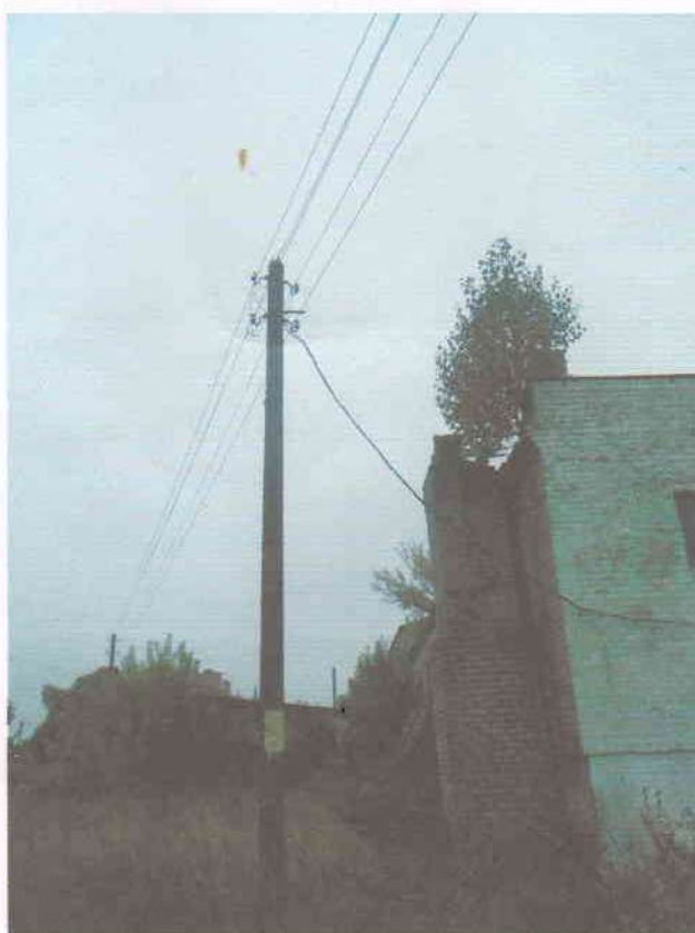
31.08.2020 г. Литер б – Сети электроснабжения
